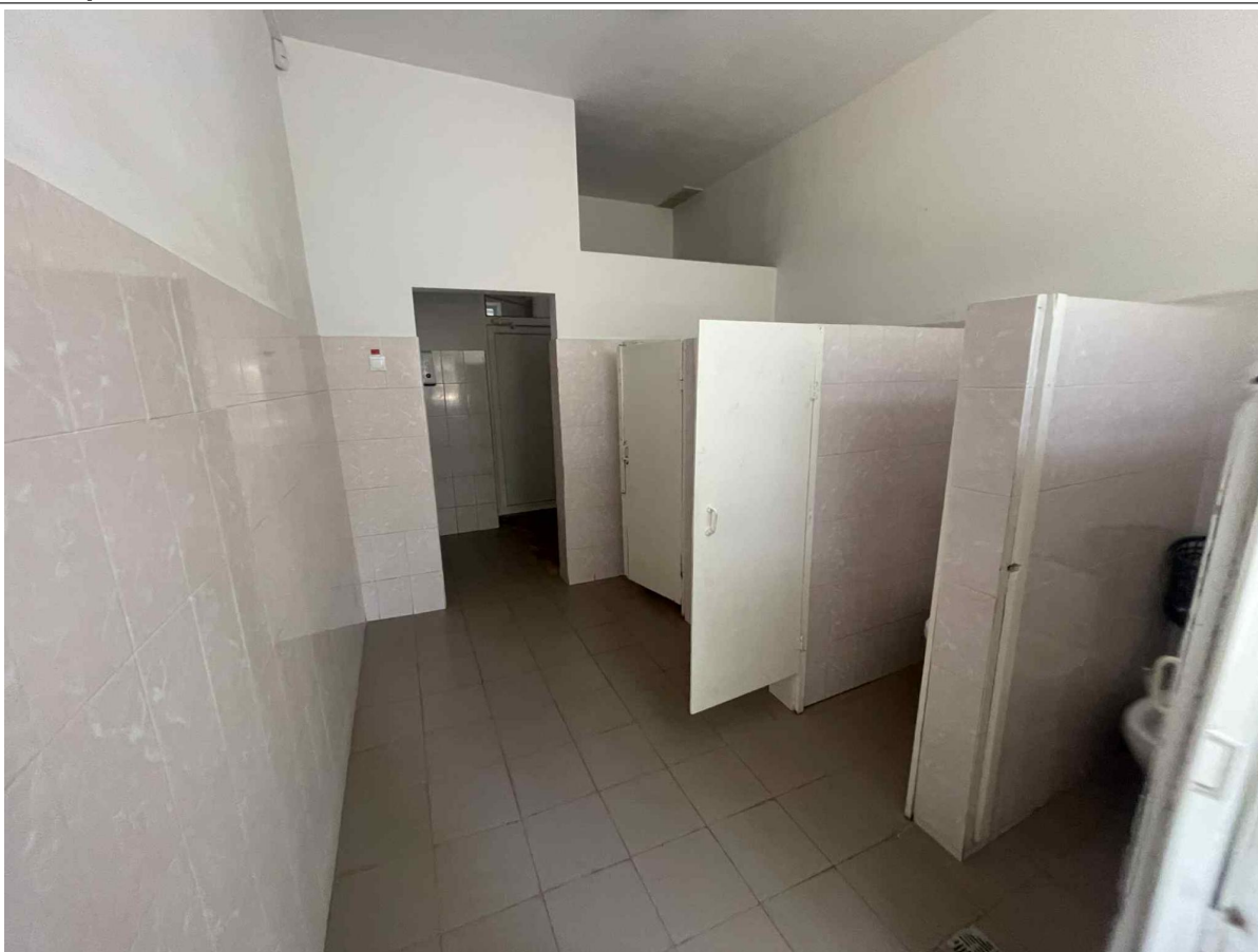
Galerie - Grup sanitar
